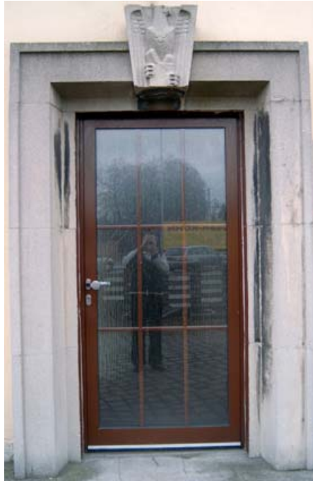
Abb. 12 Diese Tür in Brandenburg an der Havel trägt noch immer den „Pleitegeier“, den Reichsadler als Hoheitszeichen am Gebäude eines ehemaligen staatstragenden Betriebes. Das Hakenkreuz wurde notdürftig weggemeißelt. Seine vormalige Präsenz lässt sich aber noch immer erahnen. Ähnlich gilt es die ideologischen Spuren in manchen Köpfen der deutschen Bevölkerung auszumerzen, die mitunter ebenso „halb verdeckt“ noch vorhanden sind.
